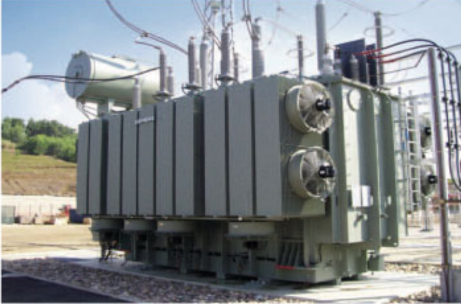
Figür2: 200 MVA Güç Transformatorü, Carvoeira, Portekiz
