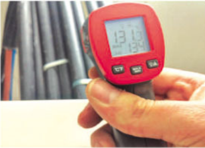
Resim 1: Kablolarda aşırı ısınma
